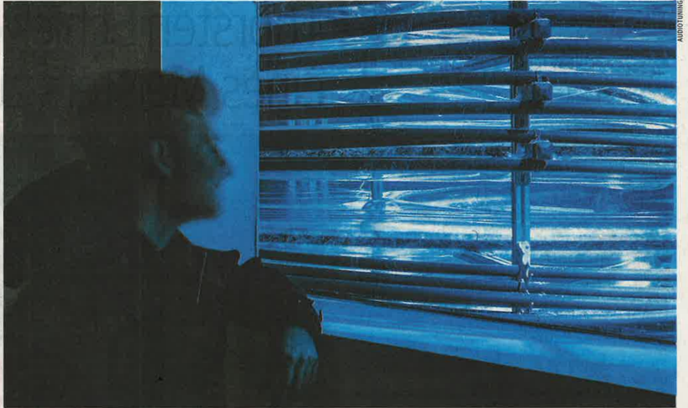
Ein Blick in den Eisspeicher bei der Pro-Ject-Audio-Zentrale. Bei Häusern und Wohnanlagen werden die Tanks üblicherweise vergraben
